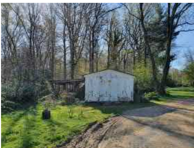
Abb. 8 In Teilen baufälliger Schuppen
